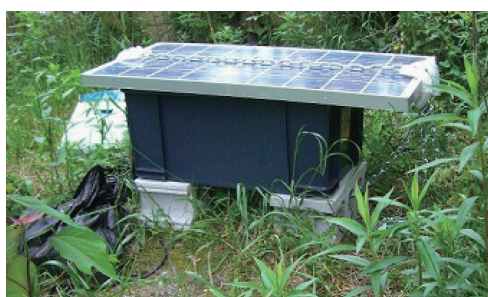
盗難にあったソーラーパネル。こちらのケースの中はデータログ、鉛蓄電池などで一杯です。
