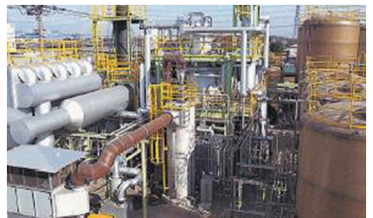
廃酸・廃アルカリの無害化処理設備(埼玉県)
